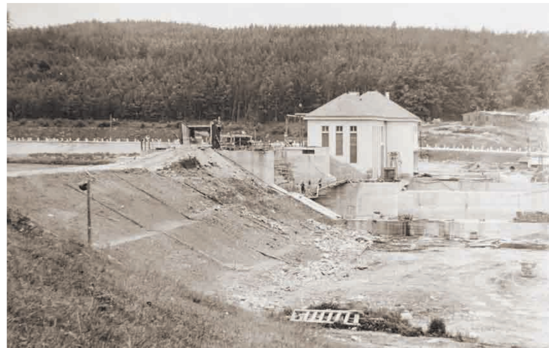
Stavba přehradní hráze Lipno II ve Vyšším Brodě, foto neznámý autor, okolo roku 1960.
